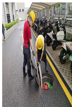
污水抽至污水处理系统
