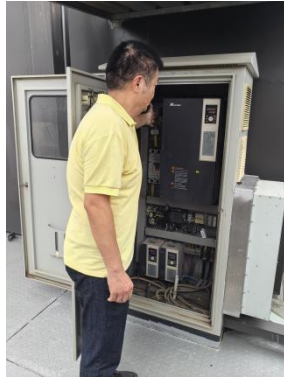
现场主管核实异常
